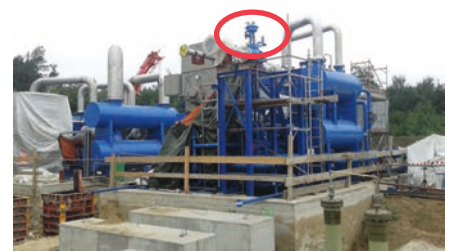
Montage der Verdichter vor Ort, oben ein Bypass-Regelventil DN200 Installation of the compressors on site; at the top, a DN200 bypass control valve
